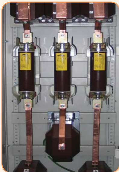
Внутренняя установка предохранителей
