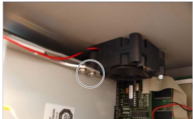
[215] Befestigung am Lüfter (hier: LH).
