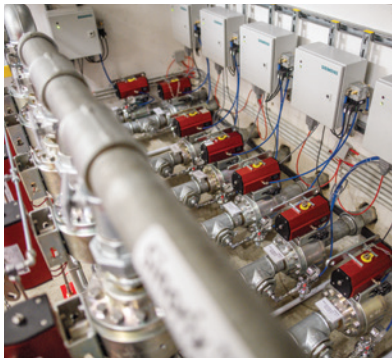
Integration der Smart Discharge Unit ins Löschesystem
