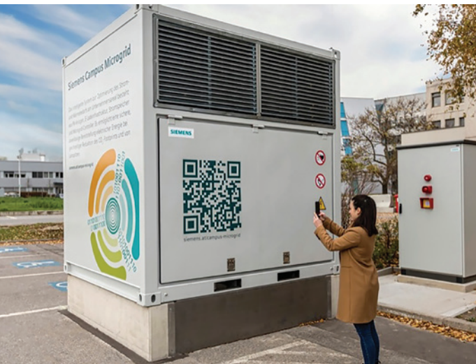
Der 500-kWh-Batteriespeicher hilft, die Nutzung der lokal erzeugten Energie zu maximieren.
