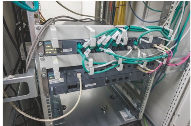
Die Switches SCALANCE X sind verteilt in dezentralen Schaltschränken eingebaut.
