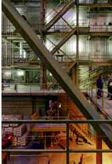
Die zwei Ofenlinien mit Filtern sind mehrere Stockwerke hoch.
