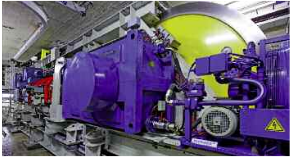
Im Rahmen der vorbeugenden Wartung wurde eines der beiden Haupt- durch das Austauschgetriebe ersetzt.
