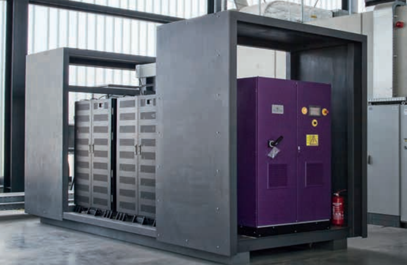
▲ Übermannshöhe Module: Batteriespeicher in Lithium-Ionen-Technologie, wie sie im Batteriepark der WEMAG in Schwerin eingesetzt werden.
