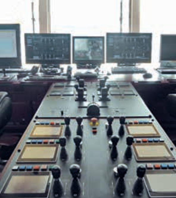
▲ Auf der Brücke liefern die installierten M1-Steuerungen mittels BIMAC-System konstant Informationen über die Anlagen an Bord.
