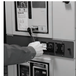
Levering Magnum DS Breaker
