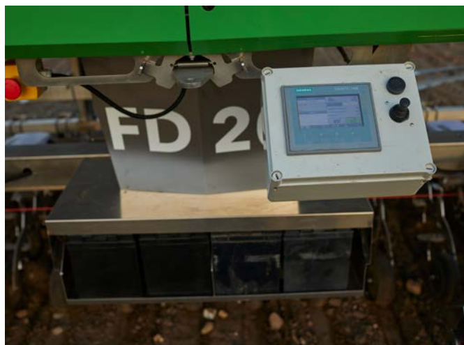
Markrobotten bliver betjent lokalt via et SIMATIC Basic HMI touch-panel. For at minimere strømforbruget er panelet slukket, når det ikke anvendes.
